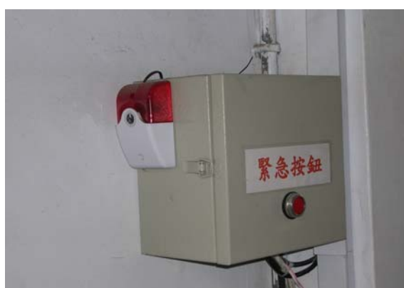
車檢站內緊急鈴按鈕 (連線操控室、大門、中央台及戒護科辦公室)
