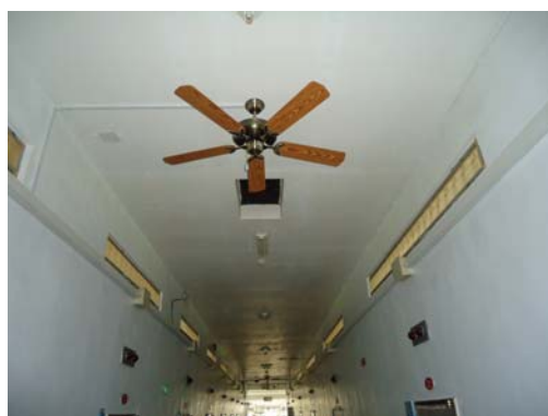
舍房走道吊扇
