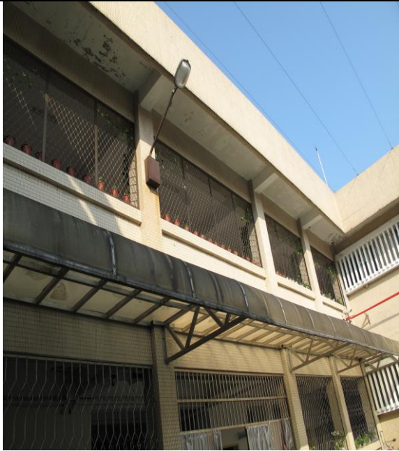
遮雨棚更新前
