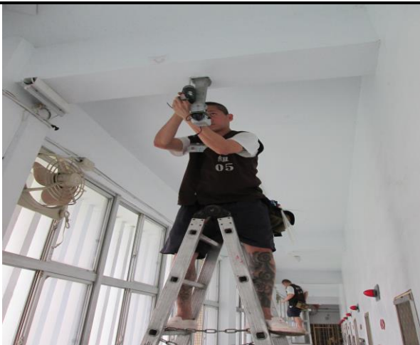
架設監視攝影機
