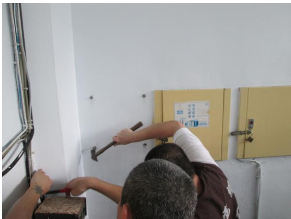
新增舍房配電箱
