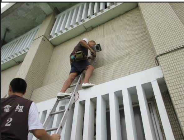
架設監視攝影機
